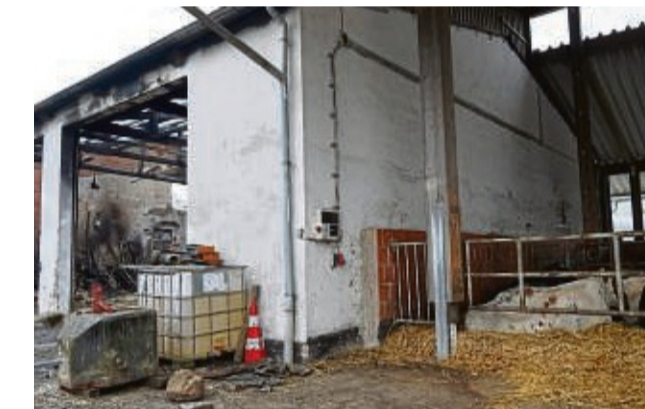
Nur durch eine Wand getrennt: Links die ausgebrannte Halle, rechts der Kuhstall.
